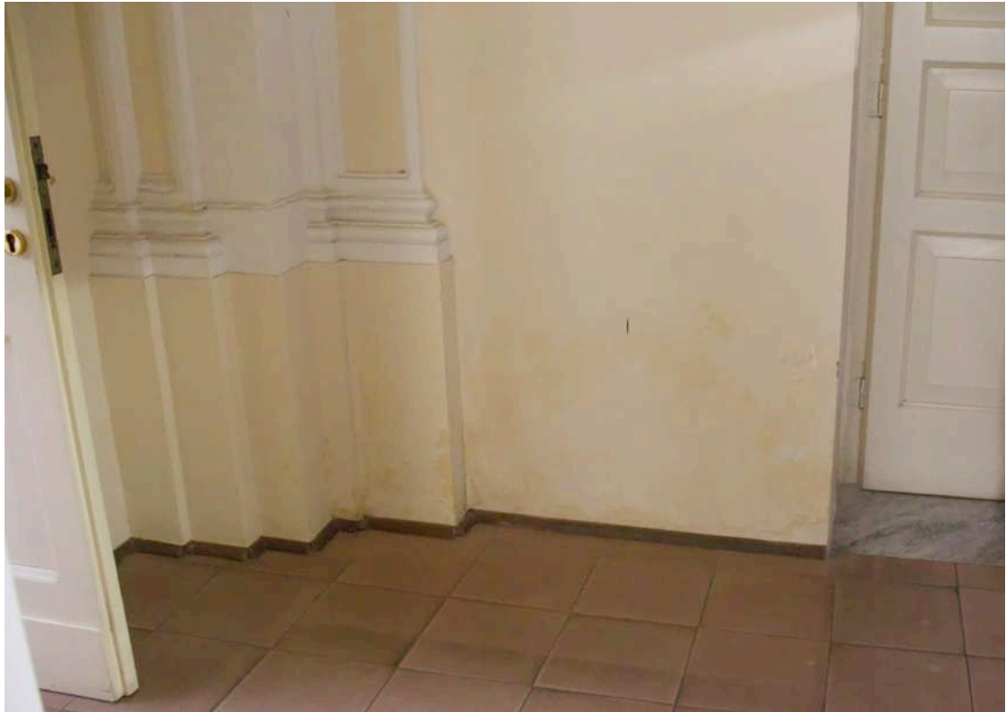
ESEMPIO DISTACCAMENTO INTONACO (INGRESSO)
