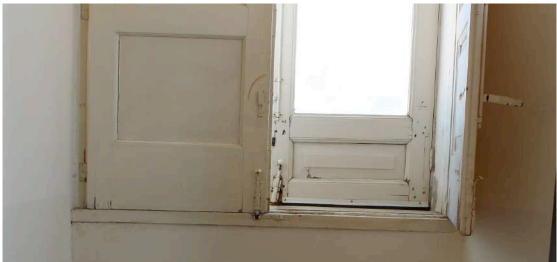
INFISSI DA RISANARE
