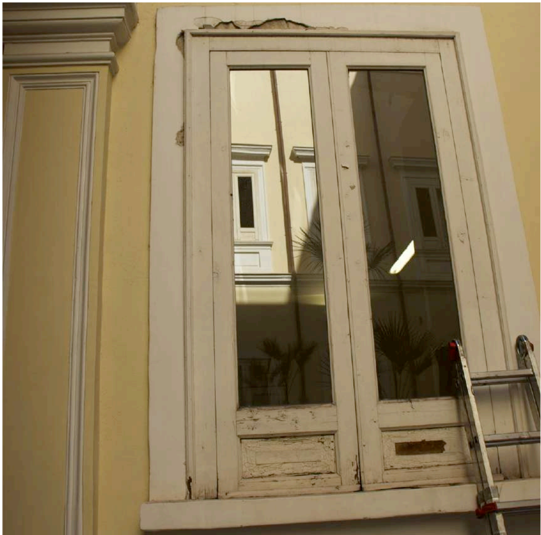
INFISSO SALA RIUNIONI DA RIPRISTINARE PER DISTACCO DA PARETE
